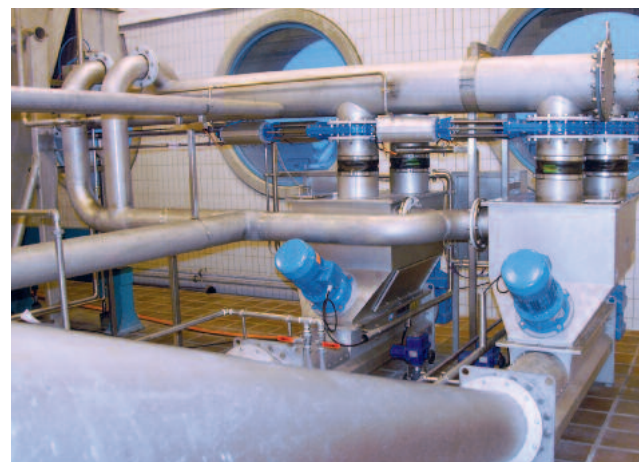
Redundante Schwemmrinnenbeschickung der HUBER Waschpressen WAP SL
