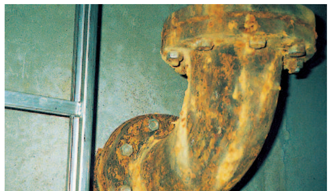
Wenn schon Sanierung – dann aber bitte konsequent!
