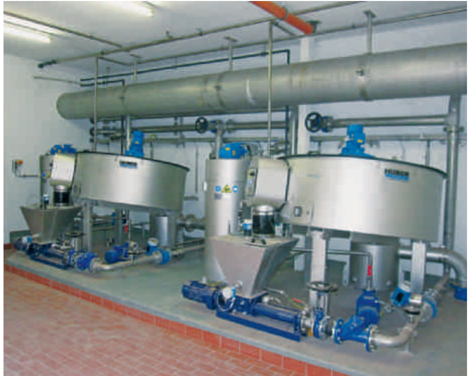
Épaisseurs à disque HUBER RoS2S – installation double sur la STEP d'Edewecht
