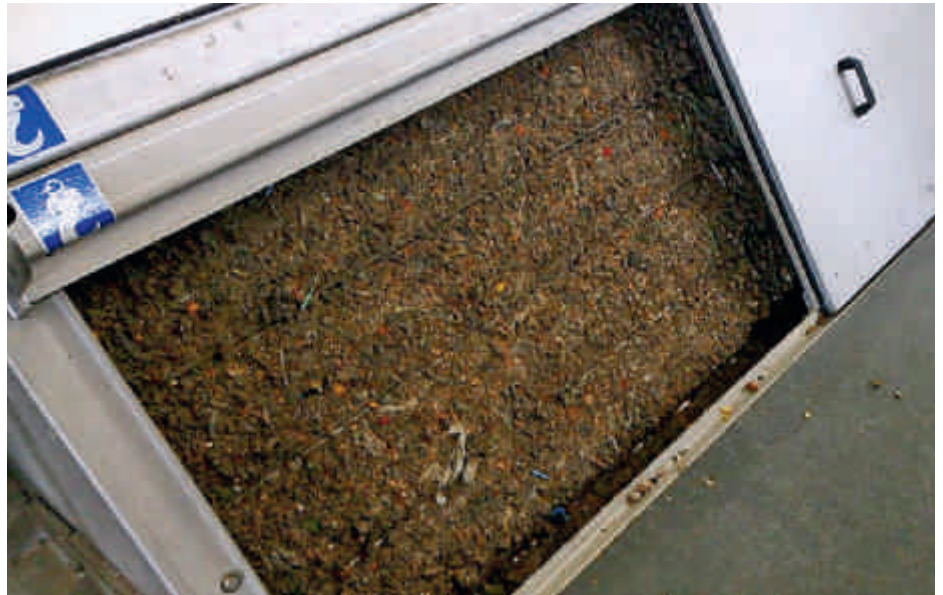
Colmatage des tamiseurs à champ déroulant HUBER ESCAMAX® pendant les essais de charge (tôles de tamisage réalisées ici sans peigne)
