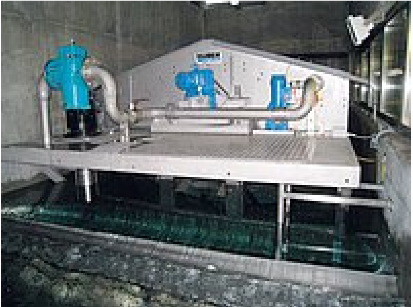
RoDisc® 10 eingebaut im Einlaufbauwerk; von hier führt eine 10 km lange Leitung zum Trinkwasser-Kraftwerk
