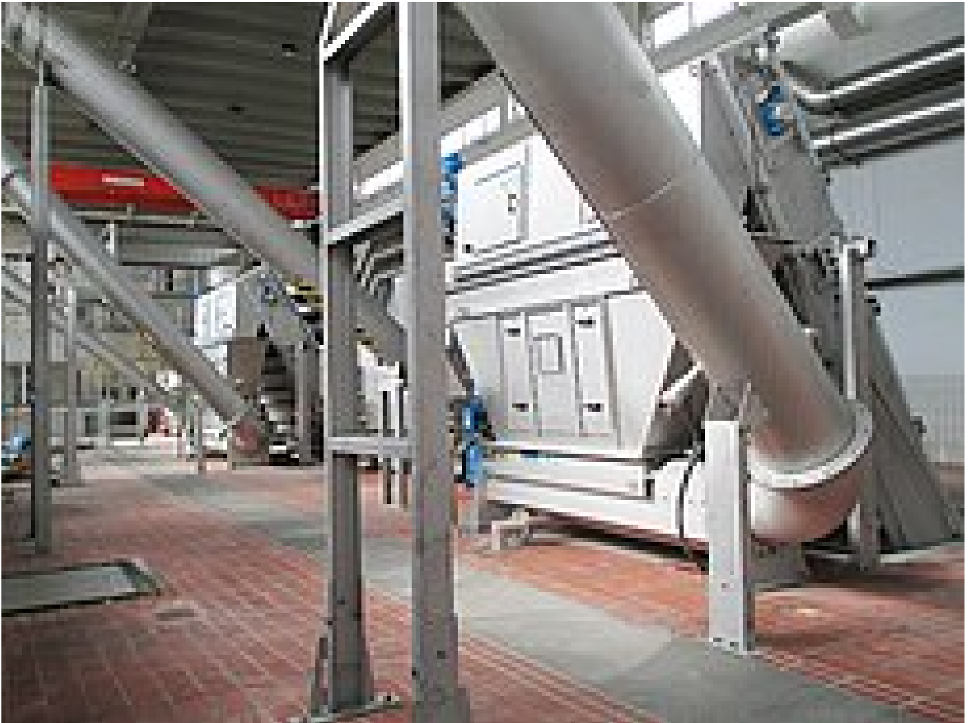
Modernste HUBER Maschinenteknik auf der Hauptkläranlage Wien
