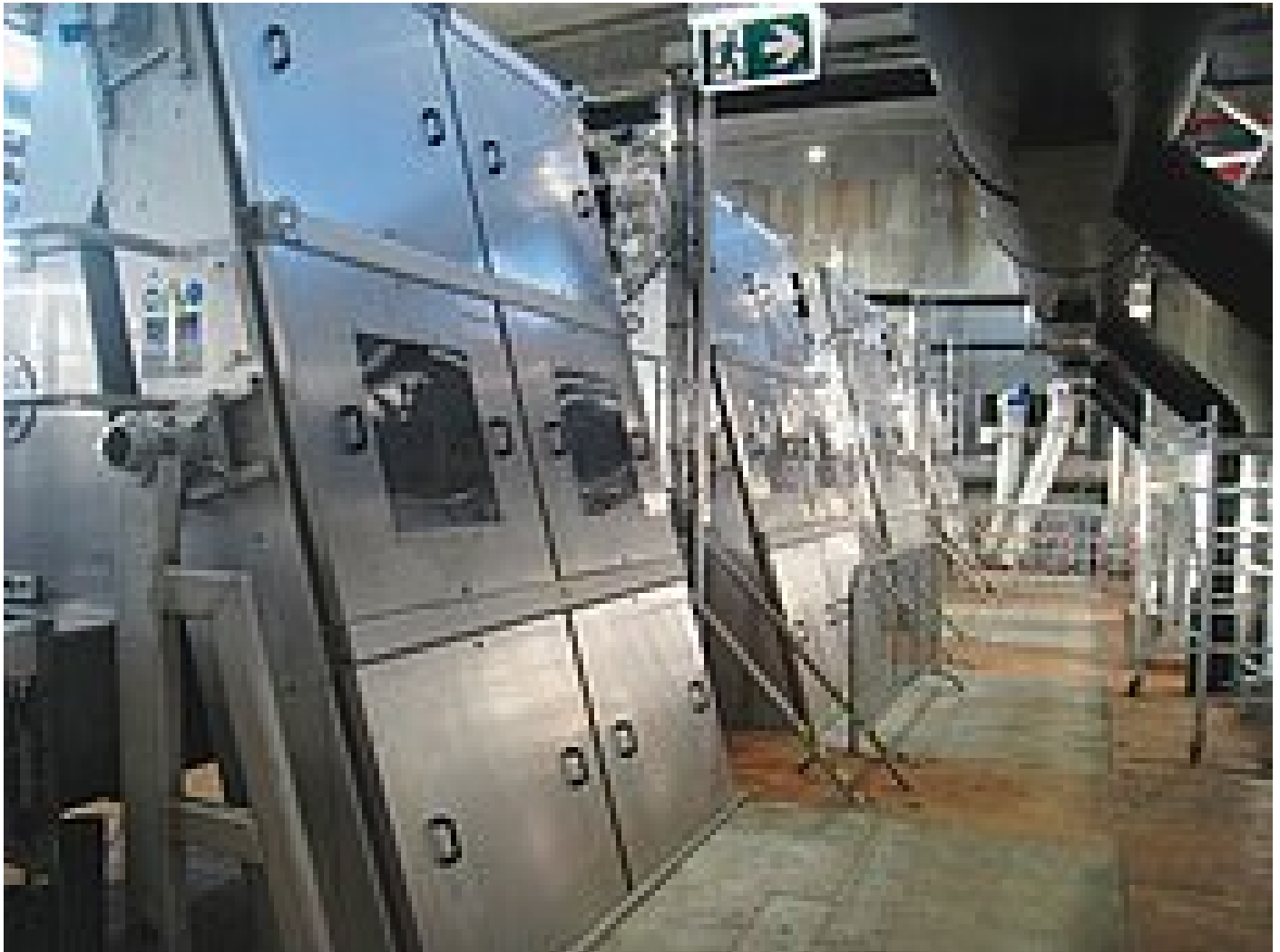
Modernste HUBER Maschinenteknik auf der größten oberösterreichischen Kläranlage Linz-Asten
