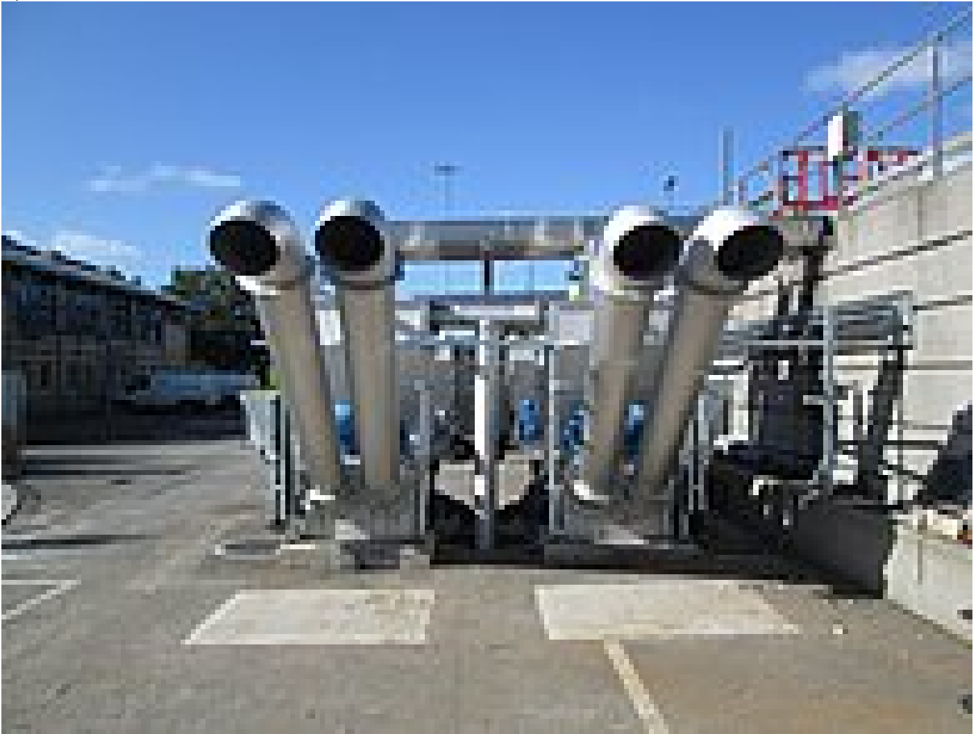
4 x WAP-SL-12 mit Durchsatzleistung 15 m 3 /h Rohrechengut pro Maschine für beste Entwässerungsleistung mit Qualitätsfaktor für Rechengut <20 mg BSB5/gTR
