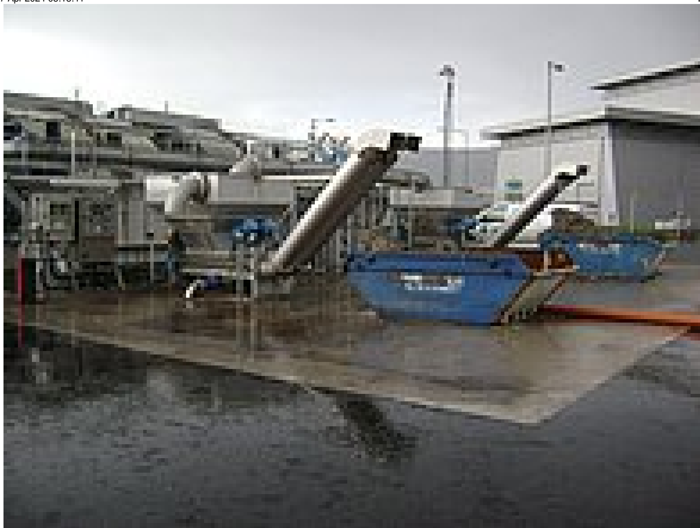
2x HUBER Waschpresse der Baureihe WAP-SL für jeweils 15 m 3 /h Rohrengut, über Schwemmrinne
