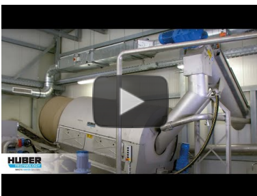
Video: HUBER Sandaufbereitungsverfahren RoSF5 - Kläranlage Schwarzenberg https://www.youtube.com/watch?v=WvEPyaISWSI
