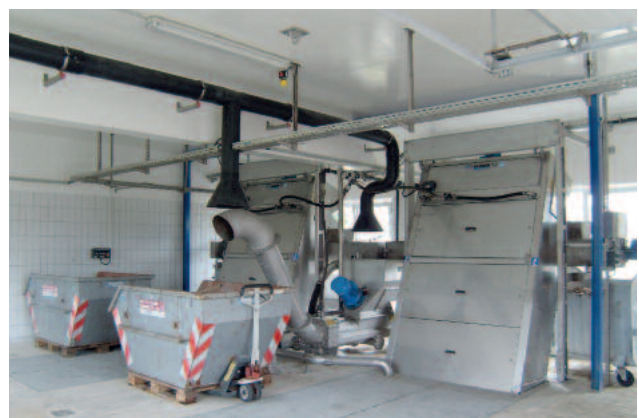
Zwei HUBER Stufenrechen STEP SCREEN® SSV, Länge 4300, Breite 1676, Spaltweite 6 mm, in Kombination mit der HUBER Rechengutwaschpresse WAP® der Baureihe SL für eine intensive Rechengutauswaschung in komplett geruchsgekapselter Ausführung.
