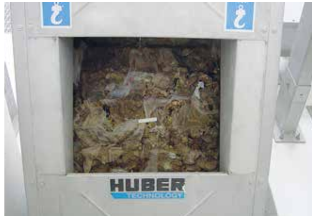
Anwendung HUBER Stufenrechen STEP SCREEN® SSF: Sehr hohe Betriebsstabilität und Sicherheit gegenüber Sand, Splitt und Steinen durch speziell ausgebildete Bodenstufe für sohlebener Rechengutabtransport.
