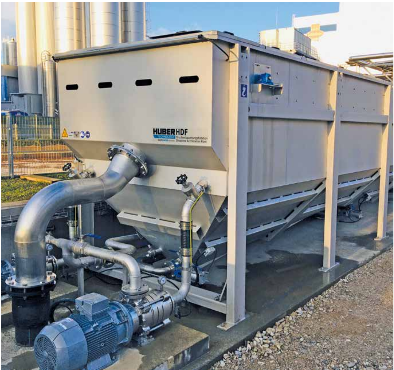
HUBER Druckentspannungsflotation HDF S installiert zur Belebtschlammabtrennung.
