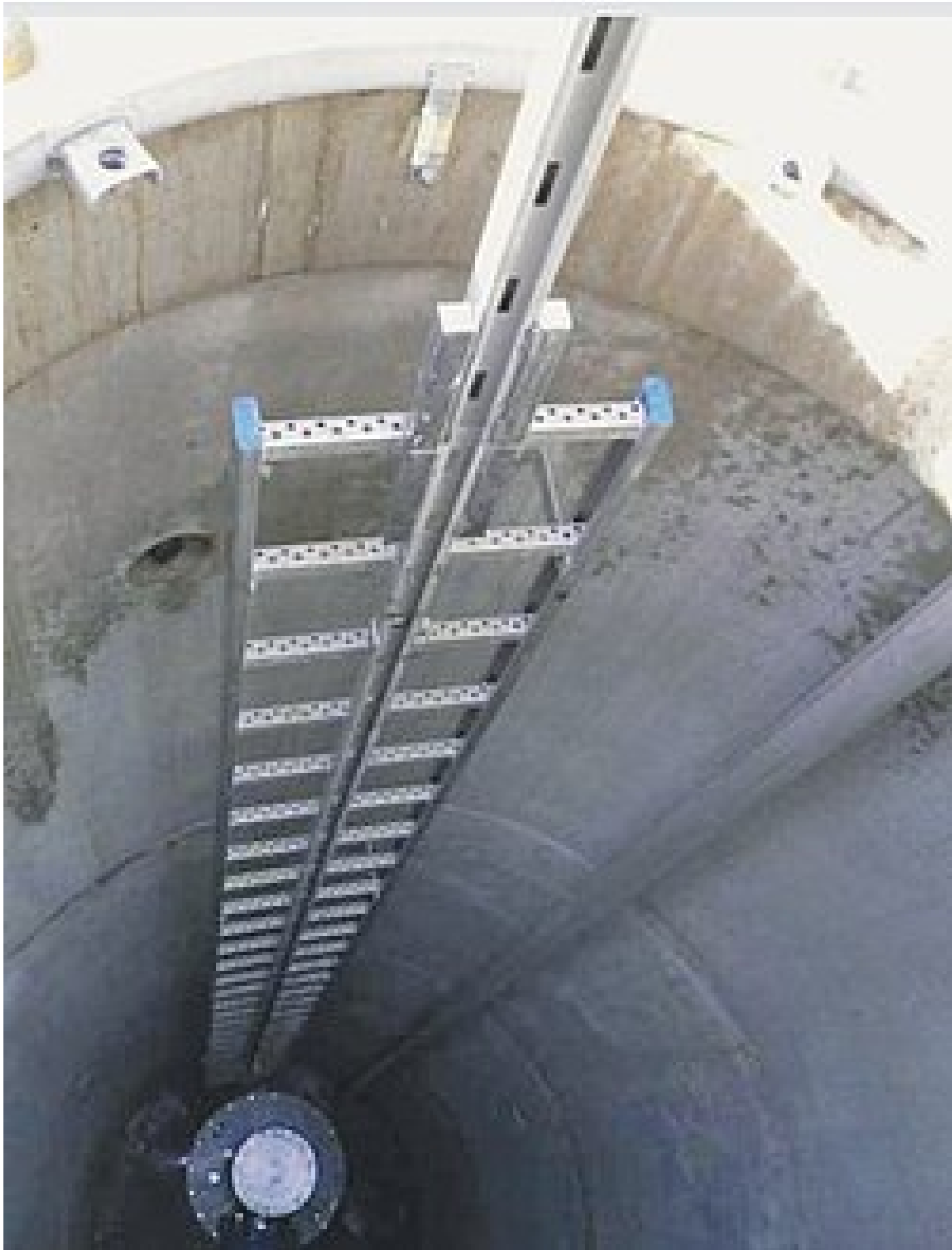
Lavorare in sicurezza: Scala con parapetto di protezione anticaduta
