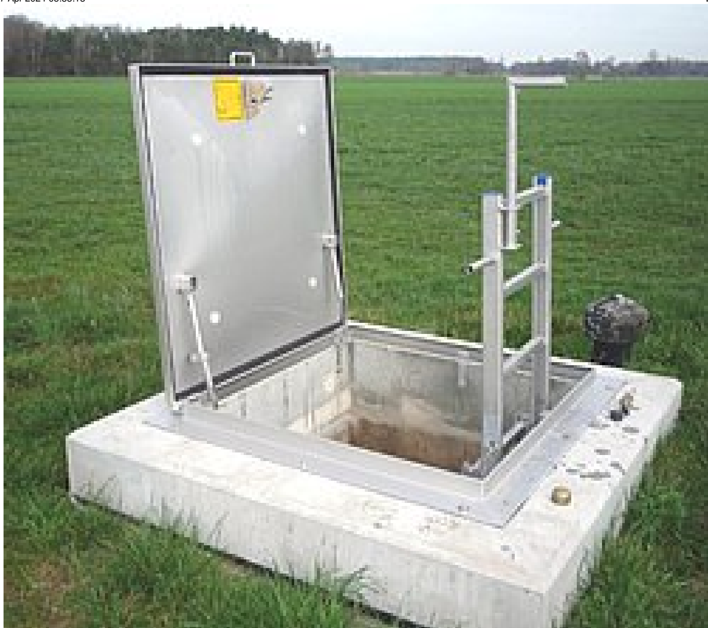
Equipaggiamento di sicurezza: Coperture per chiusini, scale di sicurezza e ausili per l'accesso ai pozzetti
