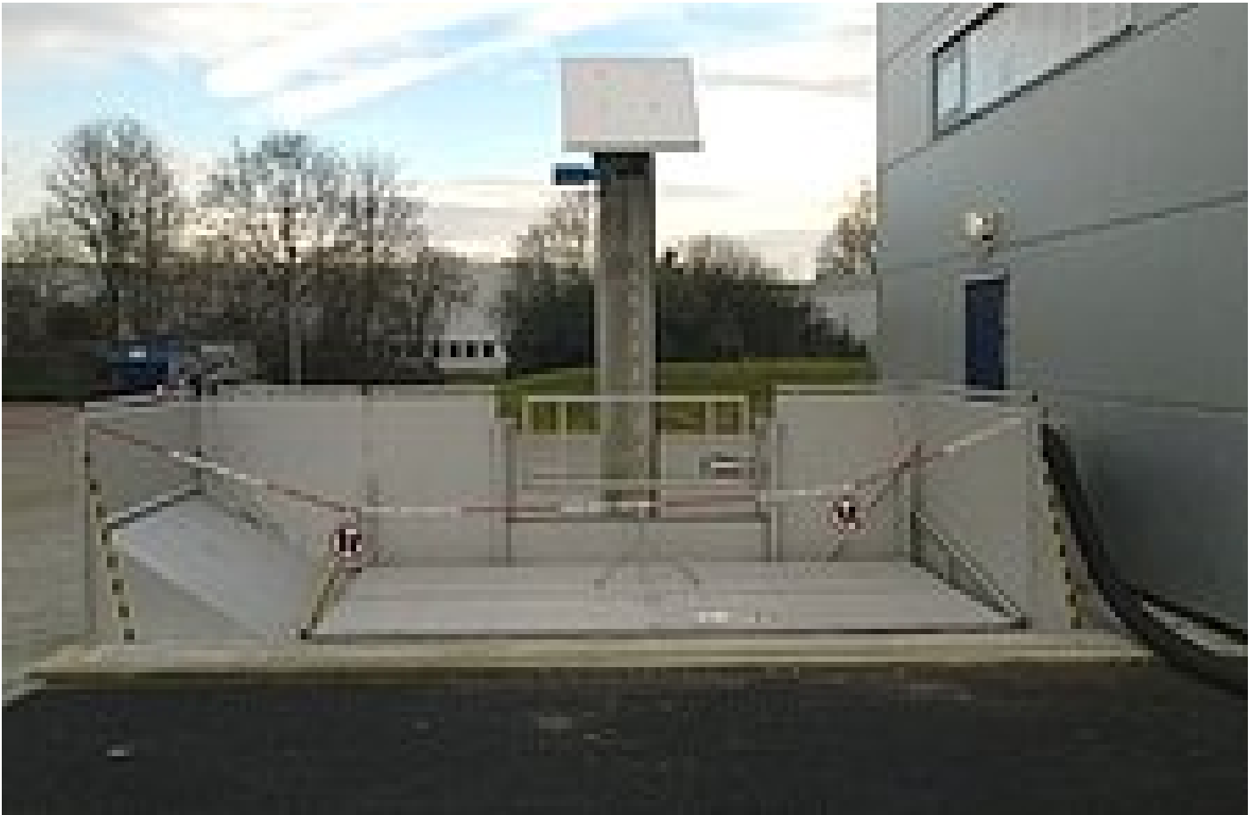
Il processo di accettazione sabbie RoSF5 HW con copertura automatica della tramoggia di accettazione presso l'impianto di depurazione di Francoforte Niederrad
