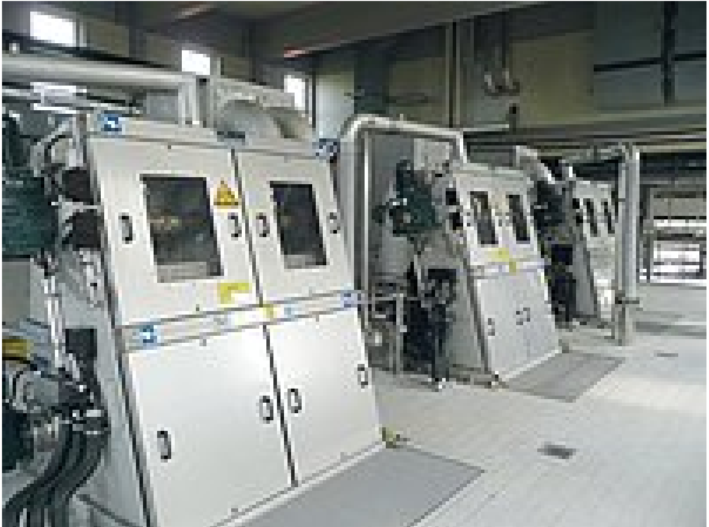
Three HUBER RakeMax® screens on WWTP Magdeburg/Gerwisch
